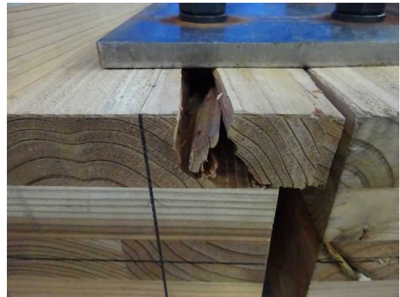
(f-4) 亀裂部分
