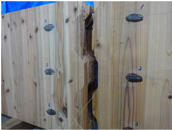
(c-3) 亀裂部分
