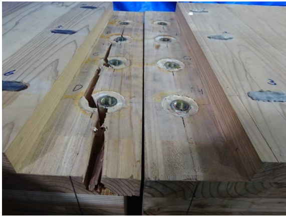
(a-3) 亀裂部分
