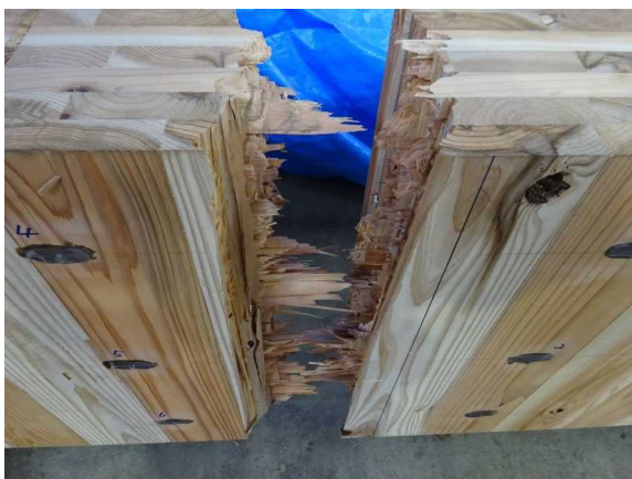
(a-5) 亀裂部分
