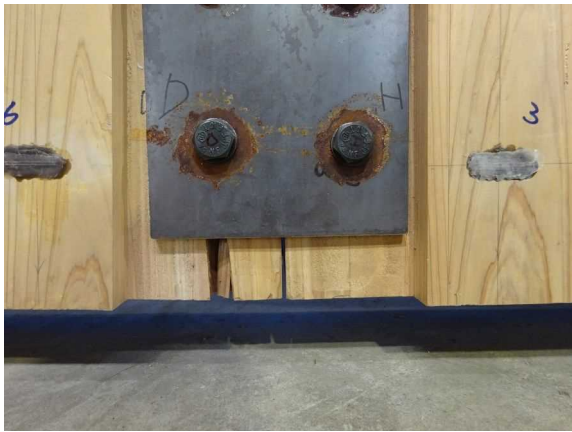
(f-3) 亀裂部分
