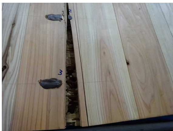
(b-4) 亀裂部分
