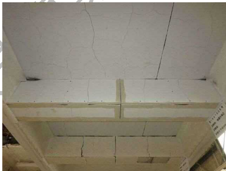
写真 26 試験後の試験体（加熱側）の状況（被覆仕様○）
