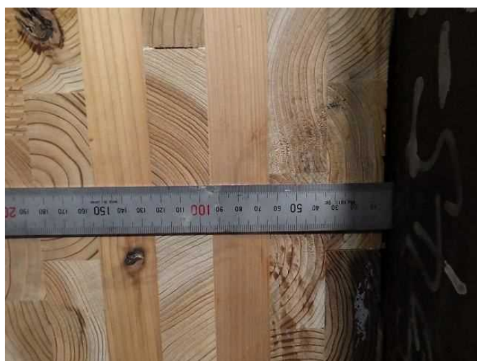
写真 3-2-22 パネルの浮き上がり
