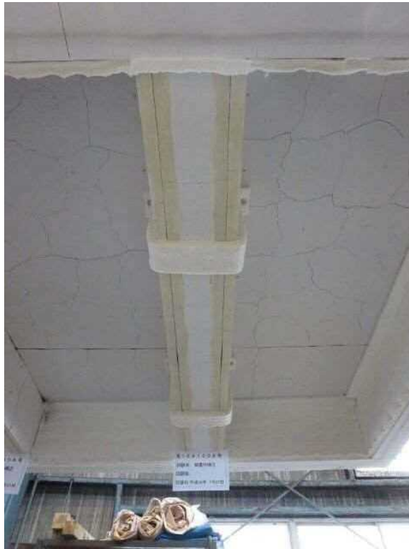
写真 27 試験後の試験体（加熱側）の状況（被覆仕様◎）
