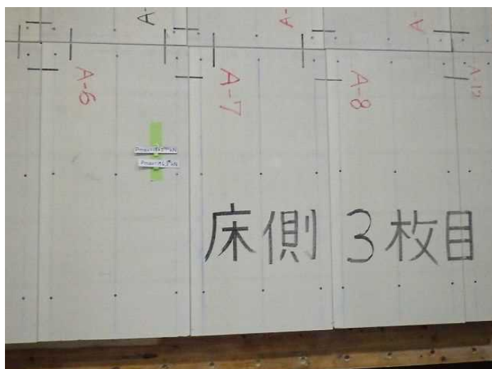
写真 3-2-17 破壊性状 (損傷なし)
