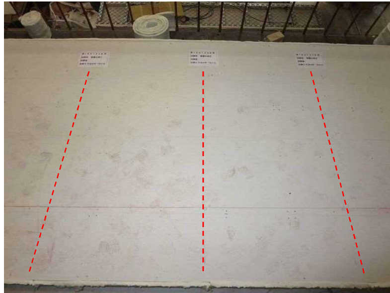
写真22 試験後の試験体（裏面側）の状況（左から被覆仕様①，②，③） （点線は，CLTパネル目地部を示す。）
