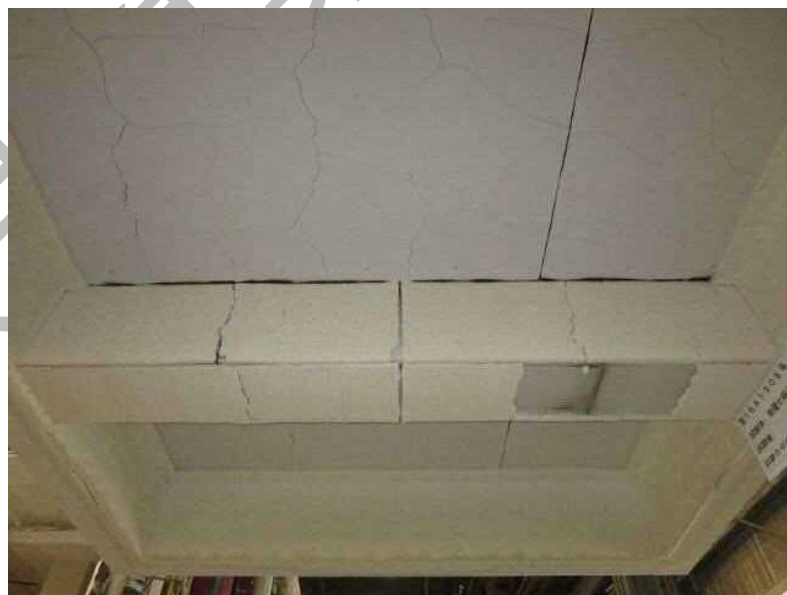
写真 24 試験後の試験体（加熱側）の状況（被覆仕様○）
