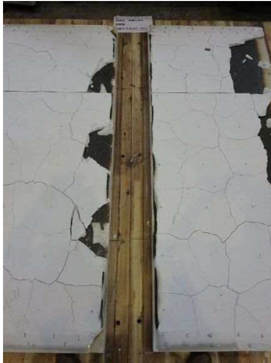
写真29 試験後のCLTパネルとはり接合部の状況（被覆仕様○）
