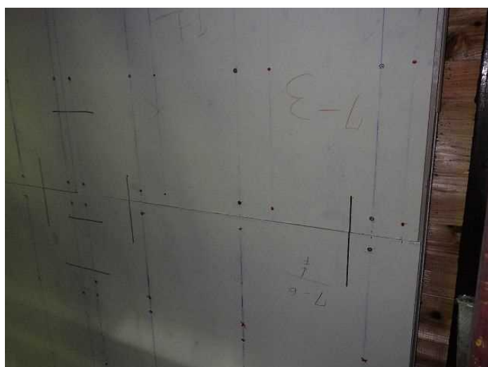
写真 3-2-18 破壊性状 (損傷なし)
