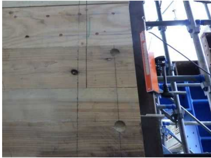
写真 3-2-4 破壊性状（損傷なし）
