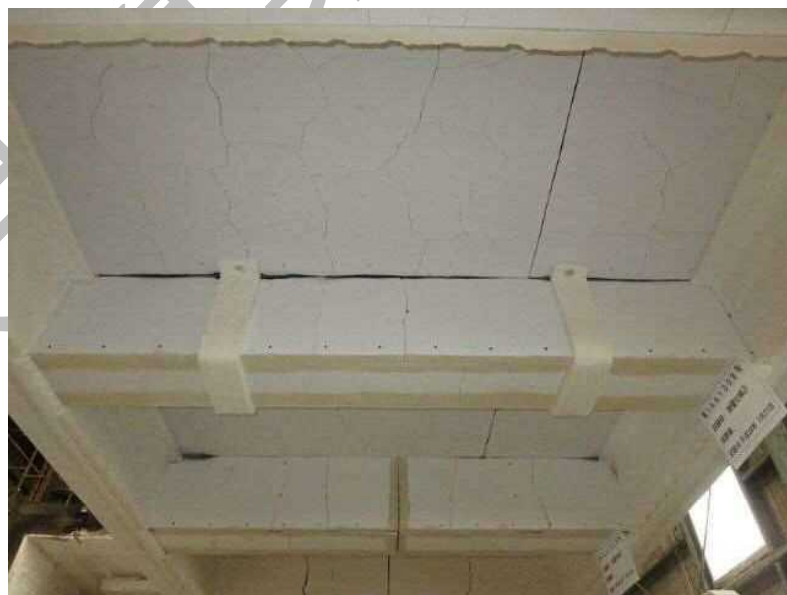
写真 28 試験後の試験体（加熱側）の状況（被覆仕様◎）
