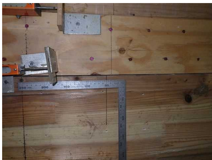
写真 3-2-21 CLT パネルとスプラインのずれ
