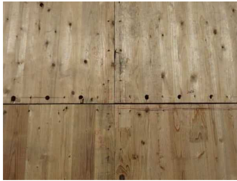
(a) 床パネル同士の隙間一例
