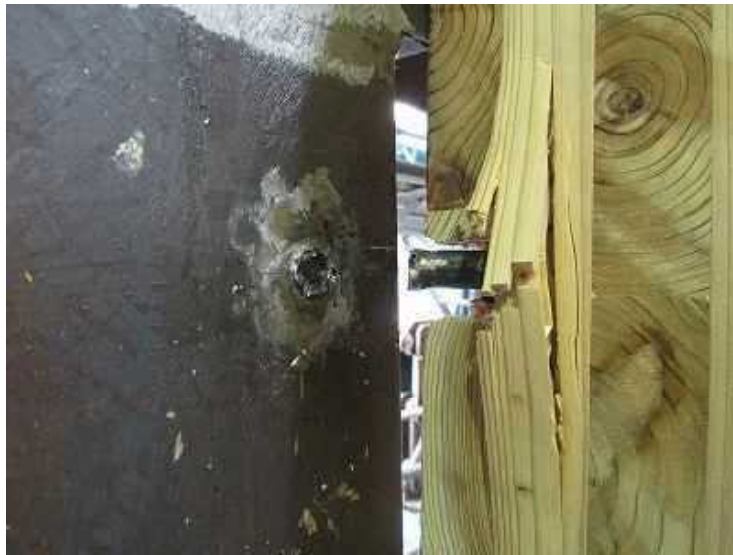
写真3 CLTの端抜け及びスタッドの破断
