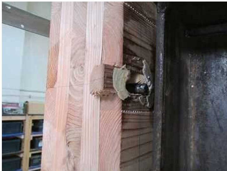
写真6 CLTの端抜け及びスタッドの破断
