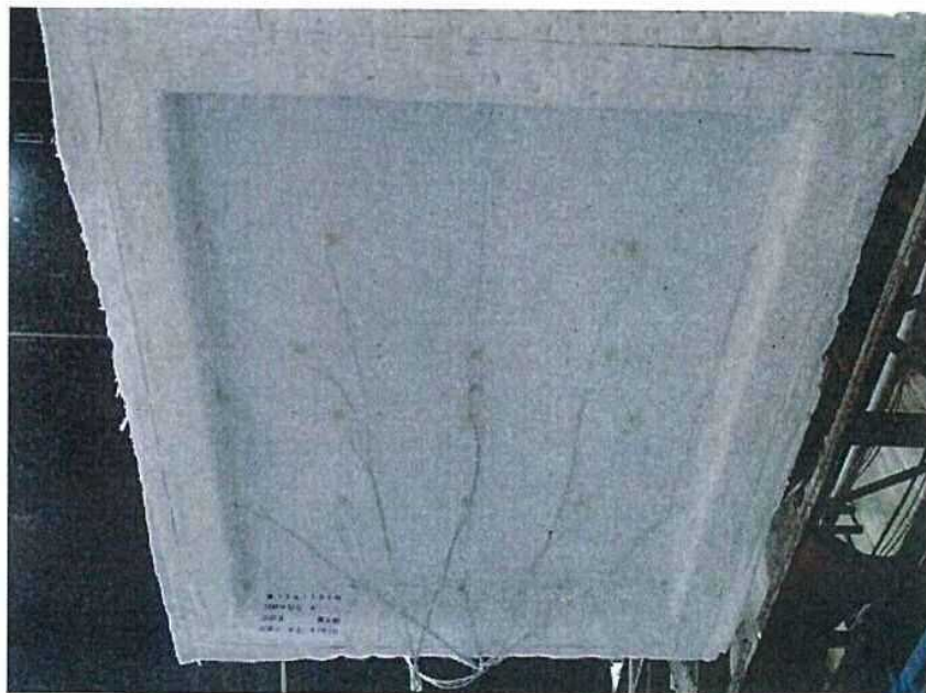
写真-11 試験後の裏面側（天井側）の状況（試験体記号B）
