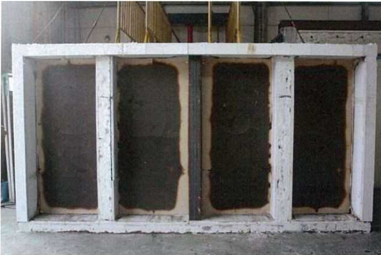
写真-5 試験後の加熱側 中張強化せっこうボード の状況（試験体記号C）
