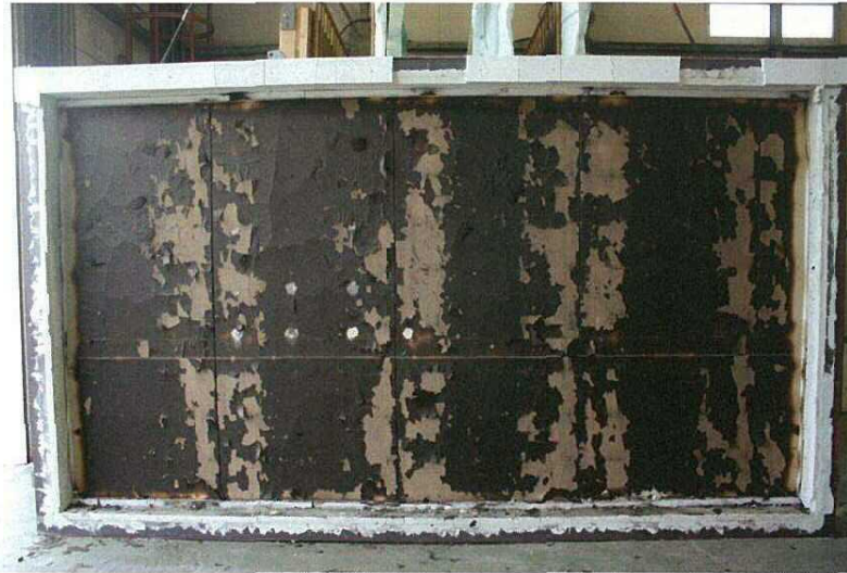
写真-16 試験後の加熱側(天井側) 中張強化せっこうボード 表面の状況 (試験体記号A2)
