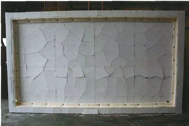
写真-5 試験後の加熱側（天井側） けい酸カルシウム板表面 の状況 （試験体記号A1）
