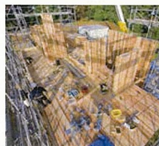
床版にU字型金物を設置し、下階の同金物にボルトで繋結して壁パネルを設置。
